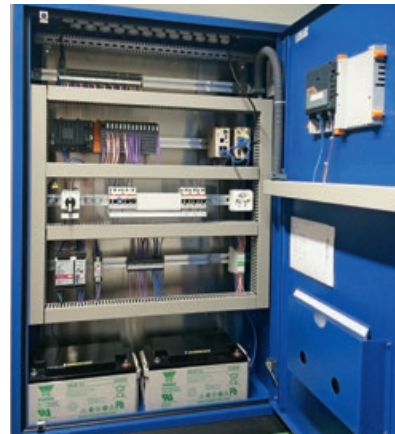
3: Aufbau Messschrank METAS.
